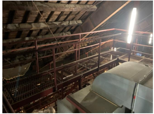
圖 2.11 鋼梁微彎折處現場情形
