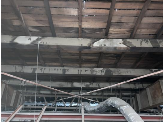
圖 2.34 桁木因後期管線吊掛而有些許下垂變形問題
