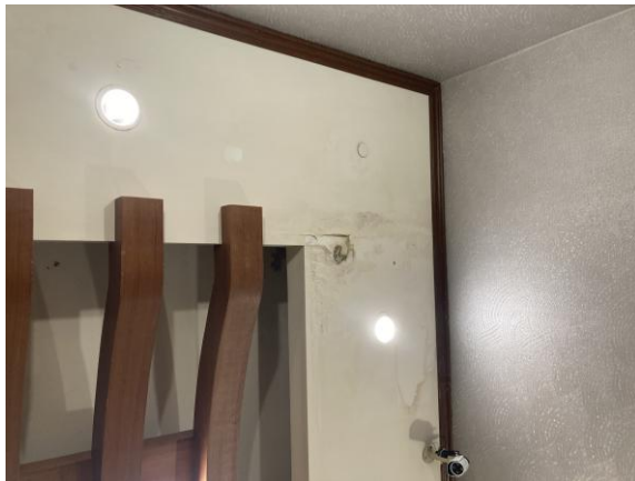
圖 2.18 RC 山牆下方漏水情形
