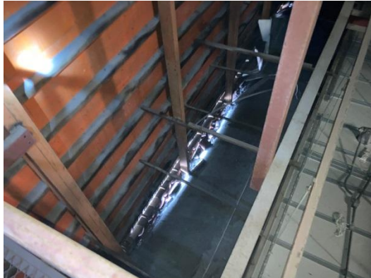
圖 2.41 山牆下側破損嚴重
