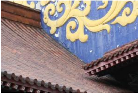
圖 2.39 牆面無抑水板
