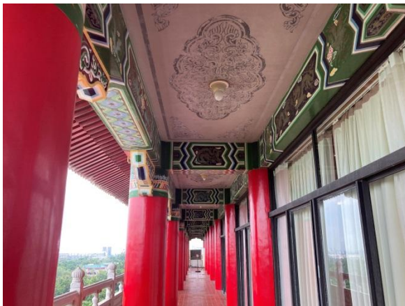
圖 2.50 半戶外區彩畫剝落情形較為輕微
