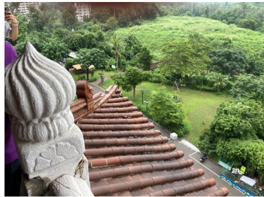
圖 2.42 戩脊破損情形
